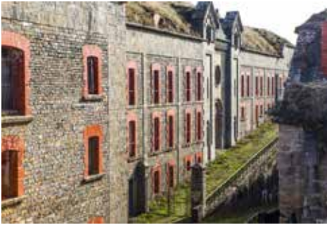
Interior del Fuerte de Alfonso XII ,en el monte San Cristóbal, el más poderoso de los fuertes poligonales del entorno pirenaico y único construido del Campo atrincherado de Pamplona.
