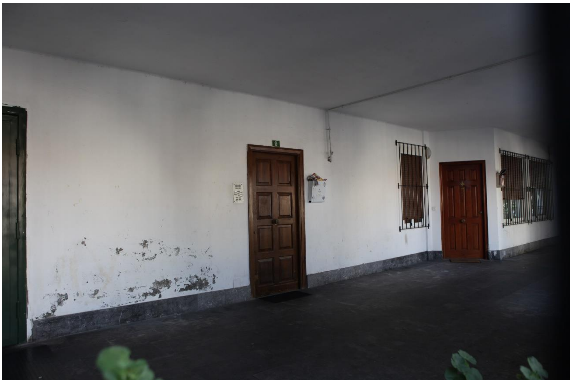
12/ Edificio 3. Portal n. 9 y accesos individuales a viviendas en la arquería, originariamente concebidos para locales comerciales.
