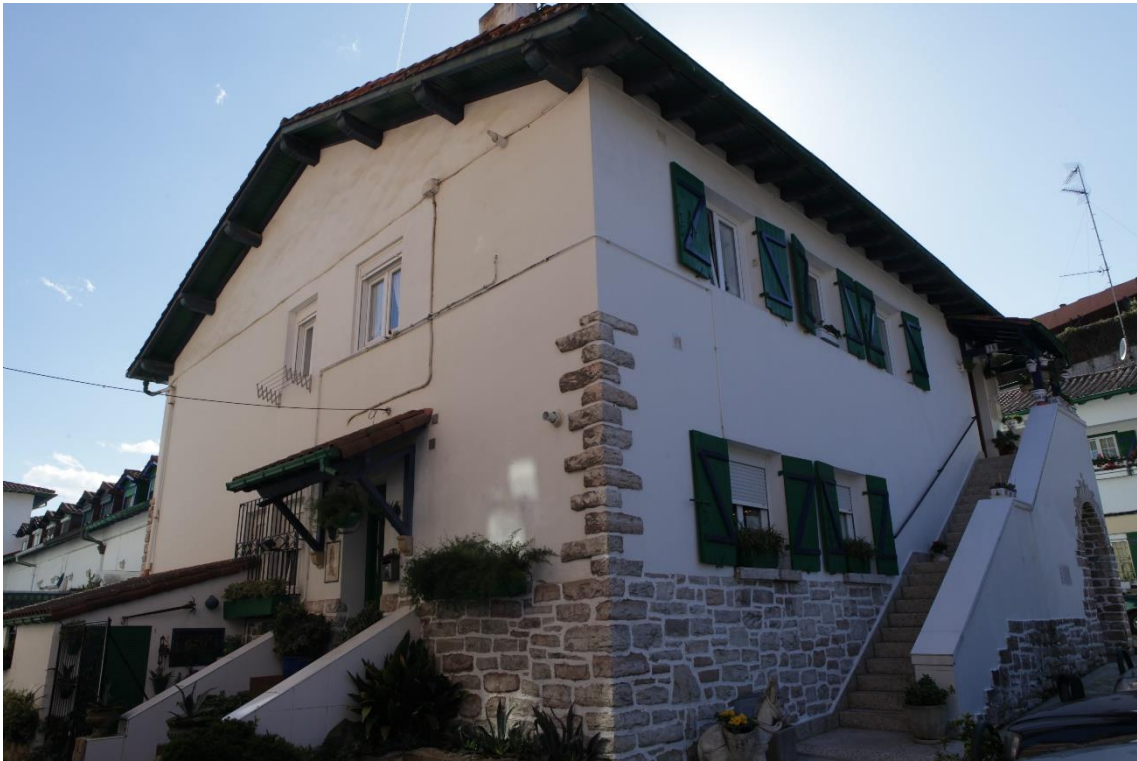
31 Varias escaleras de acceso a las viviendas del edificio. Se observa la falta de contraventanas y el anexo de una planta con tejado a un agua invadiendo incluso parte de una ventana.
