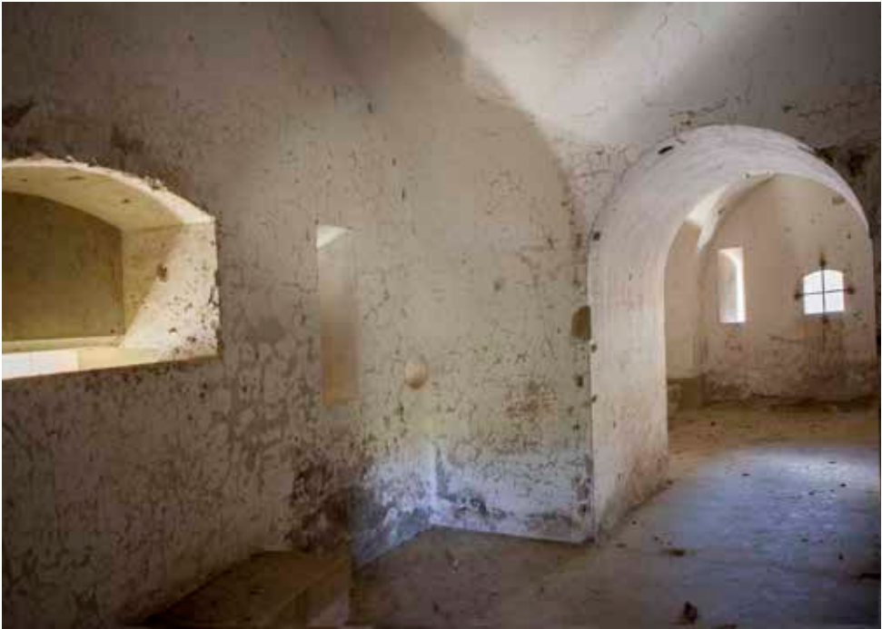
Caponera suroeste. Al fondo, la casamata frente occidental (1b) que flanquea el sector de foso que corresponde al acceso al Fuerte. En primer plano la bóveda (10) que comunica las dos casamatas de la caponera, apreciándose un matacán, una aspillera y un lanzagranadas.
