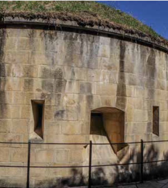
Caponera sureste. Vista desde el foso en el lugar donde no está flanqueada por artillería. Se aprecian los matacanes para defensa del fosete y dos aspilleras para defensa del tramo del foso.
